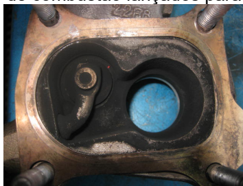
Junta montada incorretamente
