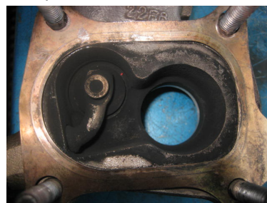
Falsch montierte Dichtung.
